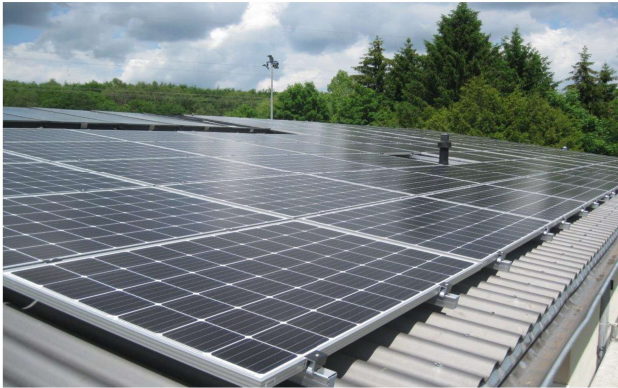
unsere 29kWp-PV-Anlage, DJK-Bildstock, errichtet. 2017
