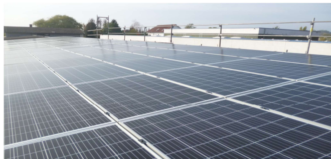
unsere 46 kWp-PV-Anlage in Ensheim, errichtet, 2020
